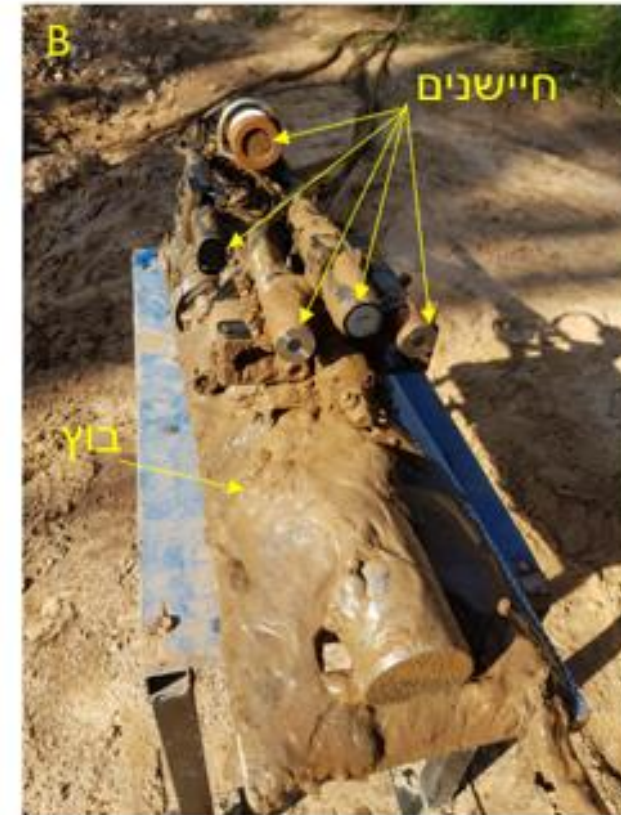
A - מארז חיישנים ומתקני ניקוי B - מארז חיישנים לאחר אירוע גשם – נדרשת תחזוקה שוטפת
